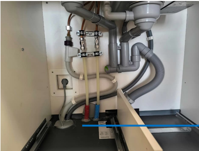
Esimerkki tiivistyssarjalla tiivistetystä allaskaapista.
